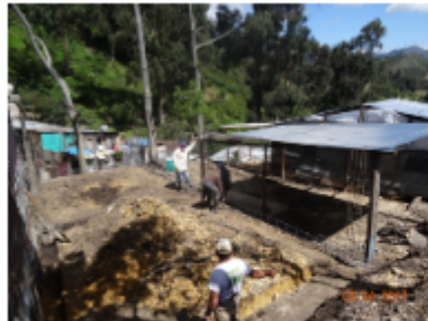
Fotografía 72. Eliminación total de horizonte orgánico del suelo original y coberturas de herbazales, herbazales arbustivos y matorrales abiertos nativos del área debido a actividades de nivelación y adecuación de terreno para viviendas informales. Fuente: SDA-SER, CT 01444 de 2017.
