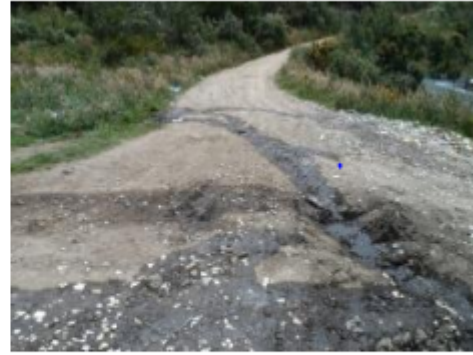
Fotografía 25. Canales en tierra con aguas residuales (24/10/2017). Fuente: SER-SDA, 2017.
