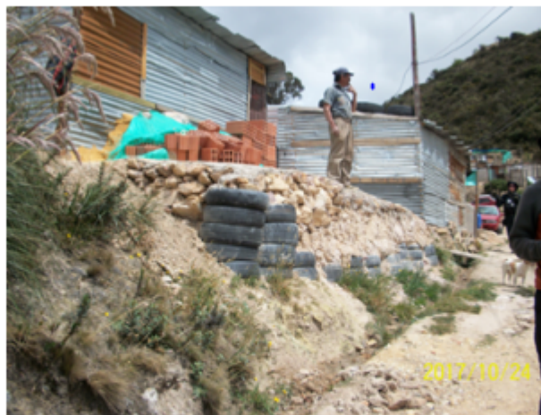
Fotografía 4. octubre de 2017. Las viviendas se encuentran ubicadas sobre zonas inestables y con sistemas de cimentación que no cumplen con los requisitos mínimos de sismo resistencia. Los rellenos no obedecen a ningún tipo de diseño técnicamente aceptable. Adicionalmente se están construyendo edificaciones de mampostería, que agregan mayor peso sobre los rellenos y zonas inestables. Fuente: SDA-SER.
