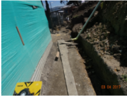
Fotografía 18. Canales construidos de manera informal para la conducción de aguas pluviales y sanitarias de las viviendas informales emplazadas. Nótase el transporte de aguas residuales en un día sin precipitación. Fuente: SER-SDA, 2017.
