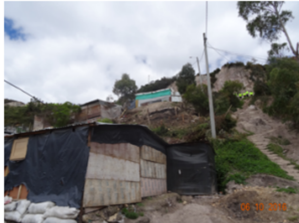
Fotografía 3. Octubre de 2016. Se observan zonas inestables con procesos activos de remoción de materiales utilizados en la construcción de las cimentaciones de las viviendas. Esta situación es de alto riesgo para la comunidad que habita el sector. Fuente: SDA-SER.
