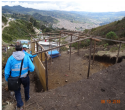
Fotografía 1. Octubre de 2016. Pérdida de confinamiento lateral por excavación para construcción. Esta pérdida de confinamiento hace que las condiciones de esfuerzos en el terreno se modifiquen y se disminuya la resistencia del mismo y se aumenten los riesgos de deslizamientos. Fuente: SDA-SER.
