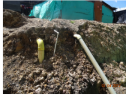
Fotografía 19. Tuberías domiciliarias sanitarias informales descargando a canales abiertos informales. Fuente: SER-SDA, 2017.
