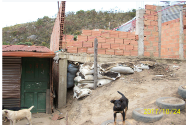
Fotografía 2. Octubre de 2017. Adicional a lo encontrado en las visitas de septiembre y octubre de 2016, ahora se observa que se están construyendo casas en mampostería y estructura de concreto con sistemas constructivos no aptos para una segura habitabilidad de los residentes. Fuente: SDA-SER.
