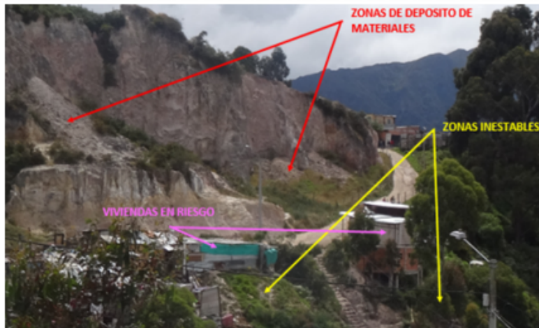
Imagen 5. octubre de 2017. En esta figura se pueden observar los riesgos para los residentes debido a zonas inestables, procesos de erosión y socavación y falta de manejo del drenaje superficial y sub-superficial. Fuente: SDA-SER, 2017.
