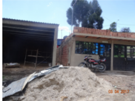
Fotografía 100: Manejo inadecuado de materiales de construcción afectando coberturas vegetales y suelos del área protegida del PEDMEN. Fuente: SDA-SER, CT 01444 de 2017.
